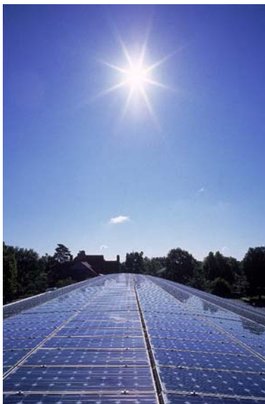
Фотоэлектрические панели в Оберлинском колледже, Оберлин, штат Огайо (Oberlin, Ohio). В этом здании на 4682 квадратных футах расположены ФЭ панели, замкнутые геотермальные скважины для обогрева и охлаждения, а также водоочистительная система, созданная по образцу природных заболоченных экосистем. (Фото любезно предоставлено Роббом Уильямсоном (Robb Williamson) и NREL).
